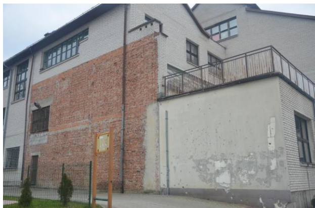
Rysunek 44. Zniszczona elewacja budynku szkoły w Przytkowicach
